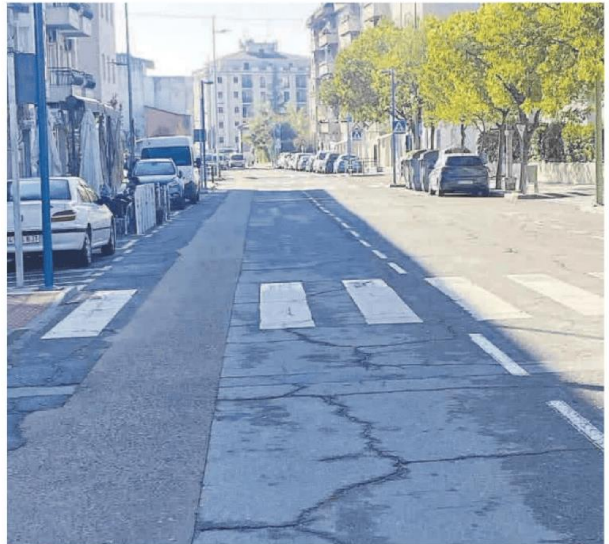
El pavimento actual de la avenida de Alfonso VII presenta visibles deficiencias con grietas.
